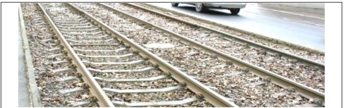
Rys. 31 Przykład wydzielonego torowiska o podkładach strunobetonowych, mocowaniu sprężystym i szynach bezстыkowych na podsypce (materiały własne)
