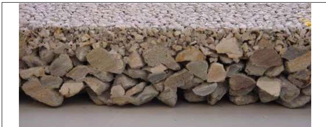
Rys. 26 Struktura nawierzchni dwuwarstwowej (źródło: Evaluation of U.S. and European Concrete Pavement Noise Reduction Methods , National Concrete Pavement Technology Center, 2006)
