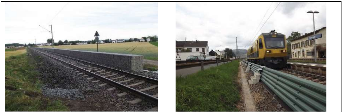
Rys. 43 Niski ekran przeciwhałasowy (wysokość 0,75 m) (źródło: DB Netze: Innovative Maßnahmen zum Lärm- und Erschütterungsschutz am Fahrweg, Schlussbericht, 2012)
